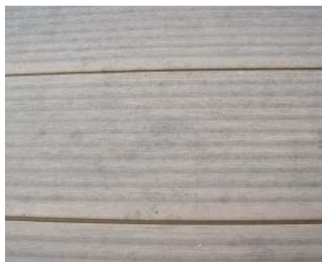
Stav povrchu dlouhodobě neudržované terasy.
